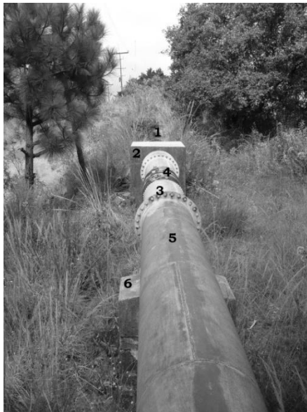
Fig. VII.26 En esta imagen se muestran los elementos que conforma la tubería de metal y se usó una nomenclatura para identificar los elementos; 1.- tubería de concreto, 2.- muro de contención, dúplex o codo, 3.- tubería metálica de tipo remachado, 4.- bridas, 5.- tubería metálica tipo blindado, 6.- murete de concreto y de contención del tubo. Fotografía Eduardo López Cruz (07/12/2007).
