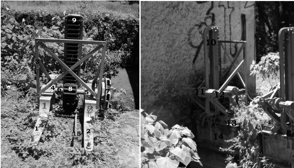
Fig. VII.8 (a y b) Imagen de la vista de las compuertas 18 y 19 en la que se muestra la nomenclatura de los elementos que la conforman y son los siguientes: 1-2.- son el soporte de toda la compuesta, 3.- estructura metálica elaborada de cuadrado y ángulo metálico, 4-5.- el molde o hueco, 6.- eje, 8.- engranaje de dentado recto, 9.- barra rectangular de dos diferentes tipos de caras, 12.- soporte metálico de la compuerta, 11.- un pequeño balero, 13.- base metálica de la cortina, 14.- cortina de concreto, 7.- es un tipo estrella, 15.- una pequeña barra circular en forma de “L”. Fotografíó Eduardo López Cruz (07/12/2007).
