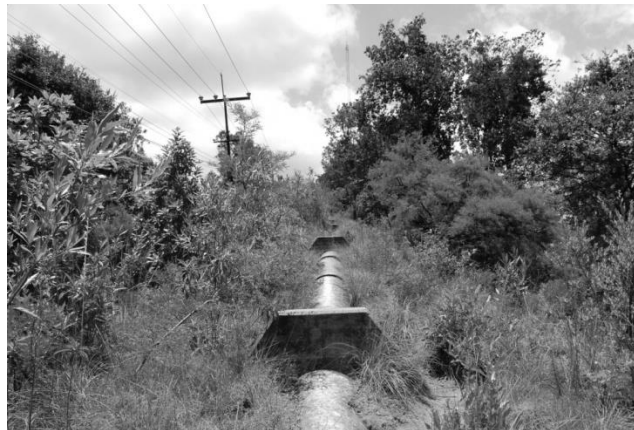
Fig. VII.25 En esta imagen se muestran la tubería de concreto la cual cuenta con unos pequeños muros de contención de concreto a una distancia de 9 m de uno a otro. Fotografió Eduardo López Cruz (07/12/2007).
