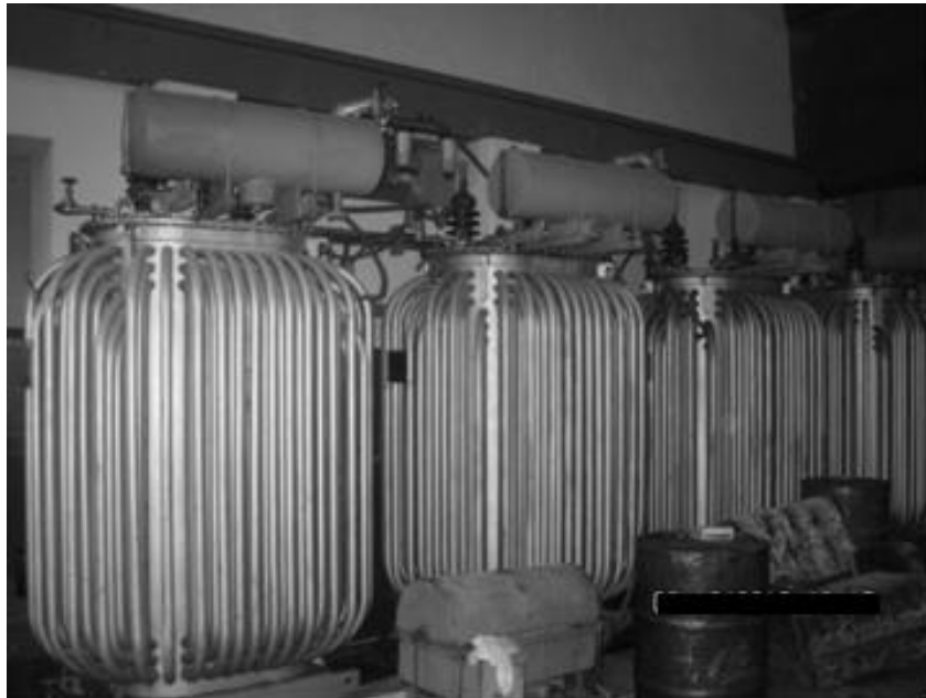
Fig. VII.57 Imagen que muestra los bancos del generador dos que sirven para la elevación de la energía generada en esta planta. Fotografíó Eduardo López Cruz (19/06/2010).
