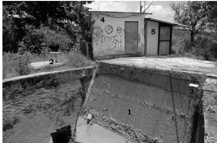
Fig. VII.21 En esta imagen se muestran los diferentes elementos que compone la cámara de presión, y se uso una nomenclatura para identificarlos; 1.- reja o filtro de metal, 2.- compuerta 27, 3.- electrodos o regulador de nivel de agua, 4.- cuarto de operador de tanque y 5.- cuarto provisional. Fotografió Eduardo López Cruz (07/12/2007).
