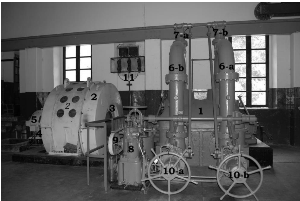
Fig. VII.55 Esta imagen muestra las partes del generador los cuales son los siguientes: 1.- muestra la carcasa y en el interior se localizan las turbinas de tipo Pelton, 2.- Es la carcasa del generador de marca "Brown boveri", 3.- Es el difusor de calor del generador, 4.- es la carcasa de los baleros de la flecha y de la banda de enfriamiento, 5.- Es el excitador del generador, 6-a y 6-b.- Tomas de agua del generador, 7-a y 7-b.- válvulas de agua de presión, 8.- Distribuidor de aceite a presión, 10.-bolantes de control de agua a las turbinas. Fotografíó Eduardo López Cruz (07/12/2007).
