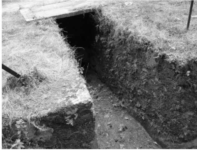
Fig. V.37, Imagen que muestra la salida del desagüe del generador además de sus características constructivas. Fotografíó Javier Campos Garduño (07/12/2007).
