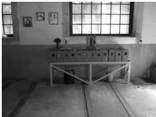
Fig. V.35 Imagen de las baterías de emergencia en la actualidad. Fotografió Javier Campos Garduño (07/12/2007).
