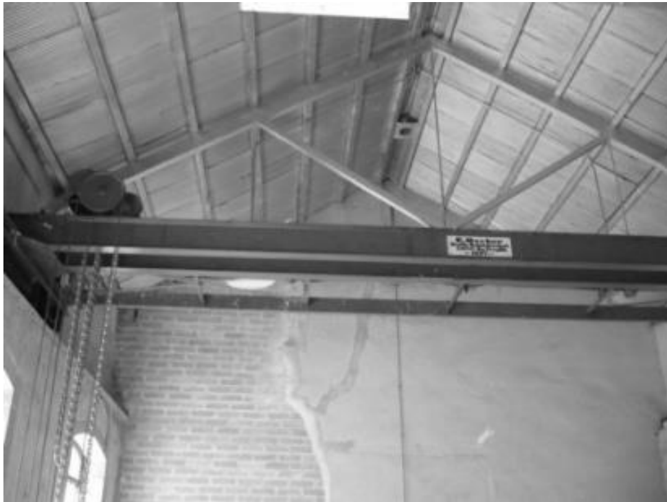
Fig. V.36 Imagen del área donde está colocada la grúa de carga. Fotografíó Javier Campos Garduño (07/12/2007).
