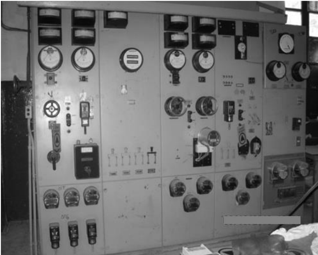
Fig. VII.58 Imagen que muestra el tablero de los generadores de esta central hidroeléctrica. Fotografió Eduardo López Cruz (19/06/2010).
