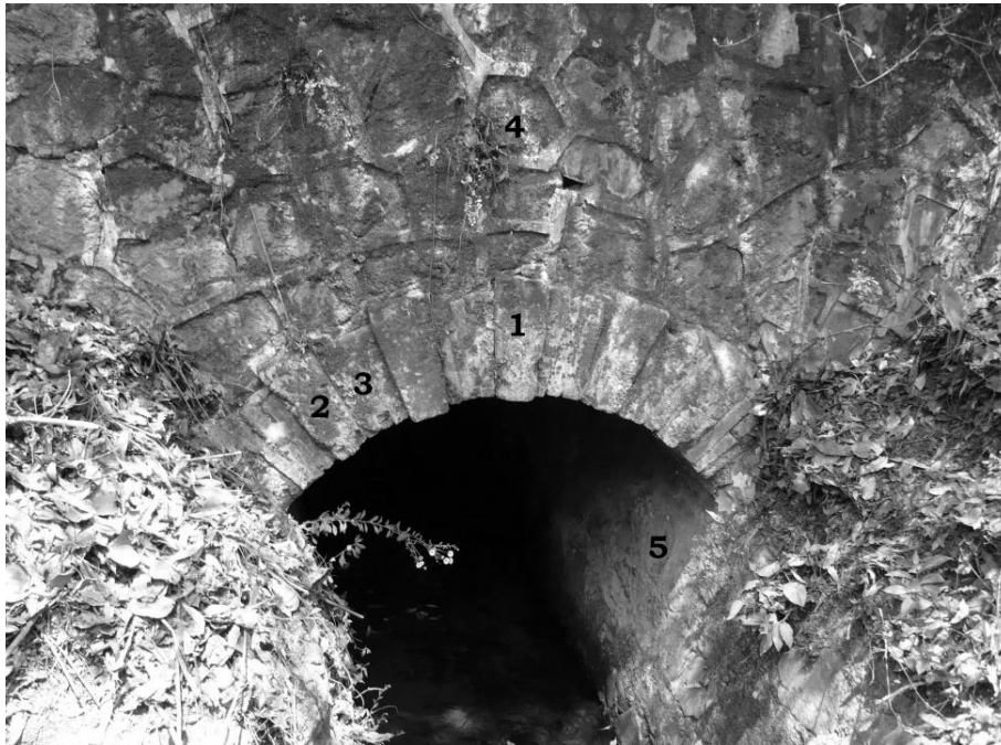
Fig. VI.8 Imagen que presenta la arquitectura del acceso al túnel, para identificar los elementos arquitectónicos los enumeramos y son los siguientes: clave (1), impostas (2), dovelas (3), riñón (4), soporte y pared del canal (5). Hugo Javier Velásquez Tolentino (07/12/2007).
