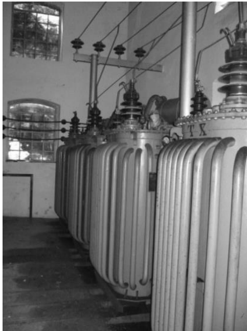
Fig. VI.27 Imagen que muestra los bancos que sirven para la elevación de la energía generada en esta planta. Hugo Javier Velásquez Tolentino (07/12/2007).
