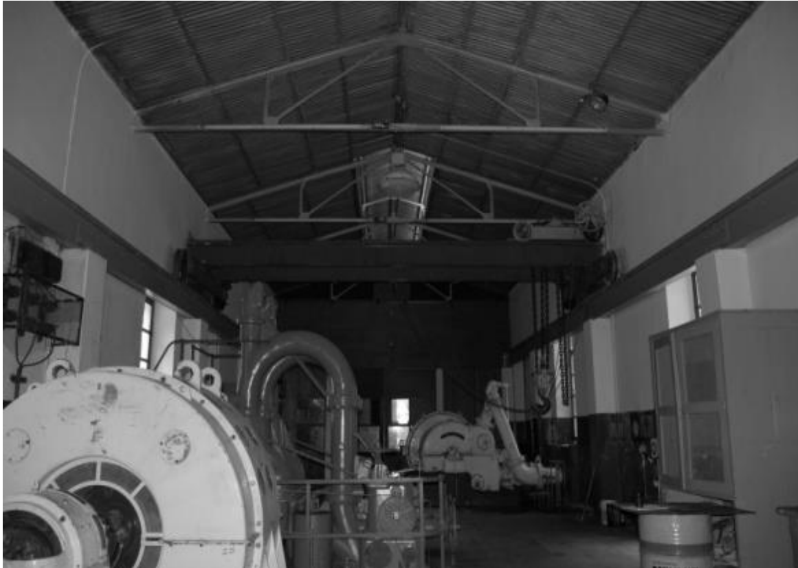
Fig. VII.59 Imagen del área donde está colocada la grúa de carga. Fotografió Eduardo López Cruz (07/12/2007).
