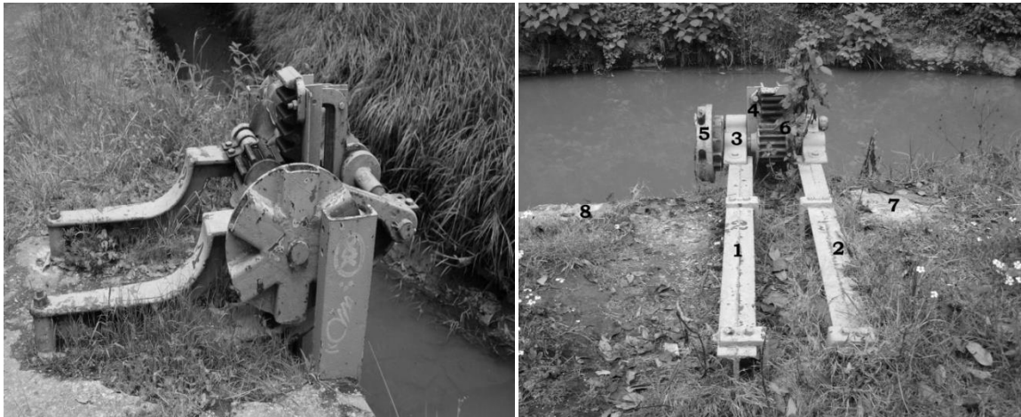
Fig. VII.9 Imagen de la vista de la compuerta 24 la cual presenta los mismos elementos de ensamble y medidas que las compuertas 18 y 19 localizadas en la presa de San Simonito. Fig. VII.10 Imagen de la vista de la compuerta 24 en la que se muestra la nomenclatura de los elementos que la conforman y son los siguientes: 1-2.- son el soporte de toda la compuerta, 3.- el molde o hueco, 4.- barra rectangular con dentado, 5.- es un tipo estrella, 6.- engranaje de dentado recto, 7-8.- muretes de concreto. Fotografíó Eduardo López Cruz (07/12/2007).
