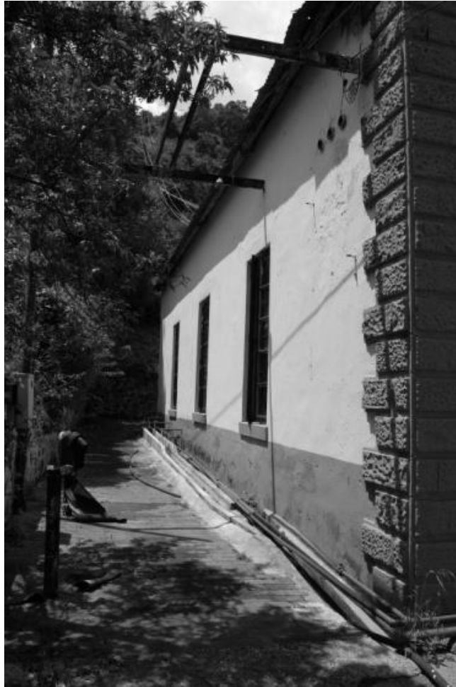
Fig. VII.49 Imagen de la vista exterior este de la planta de San Simonito en la cual se aprecian sus características arquitectónicas. Fotografió Eduardo López Cruz (07/12/2007).
