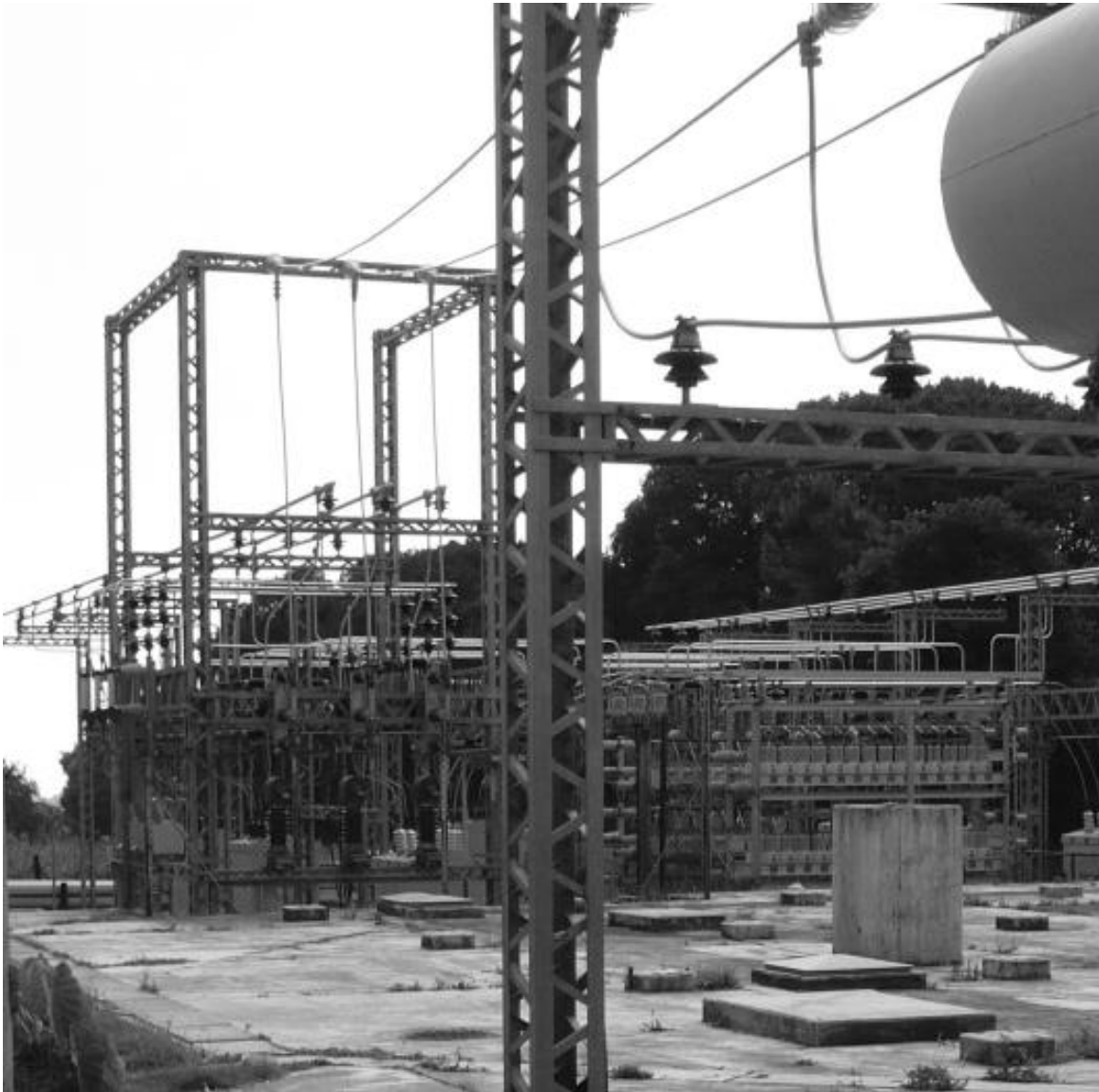
Fig. V.42 Imagen del área de baja tención de la subestación de Zictepec. Fotografíó Eduardo López Cruz (07/12/2007).
