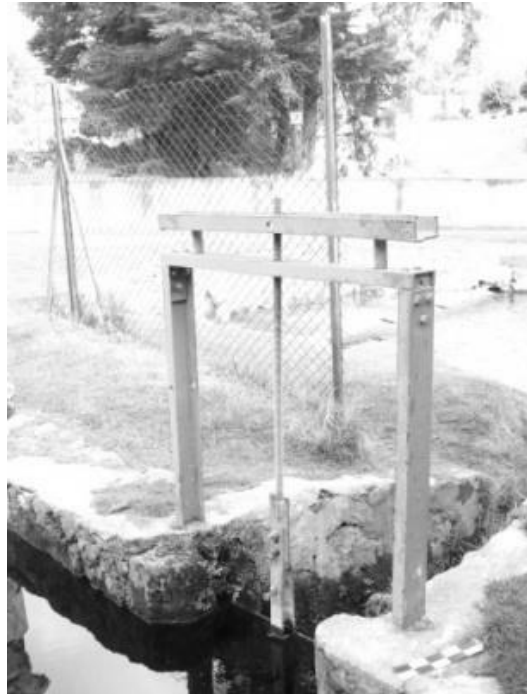
Fig. V.5 Imagen de la compuerta numero uno que presenta las características de una compuerta vertical. Fotografió Javier Campos Garduño (07/12/2007).
