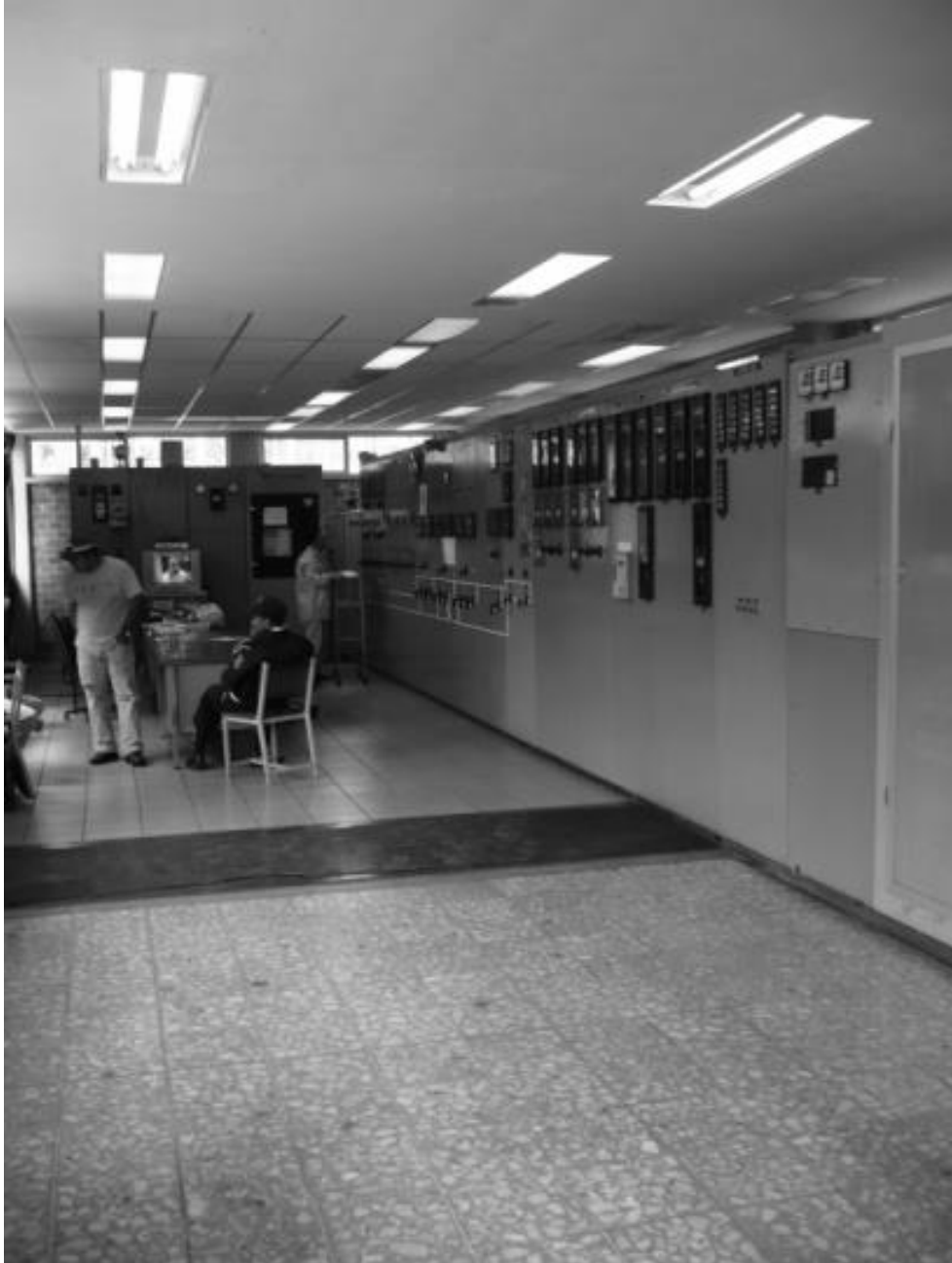
Fig. V.43 Imagen del área control de la subestación de Zictepec. Fotografió Hugo Javier Velásquez Tolentino (07/12/2007).
