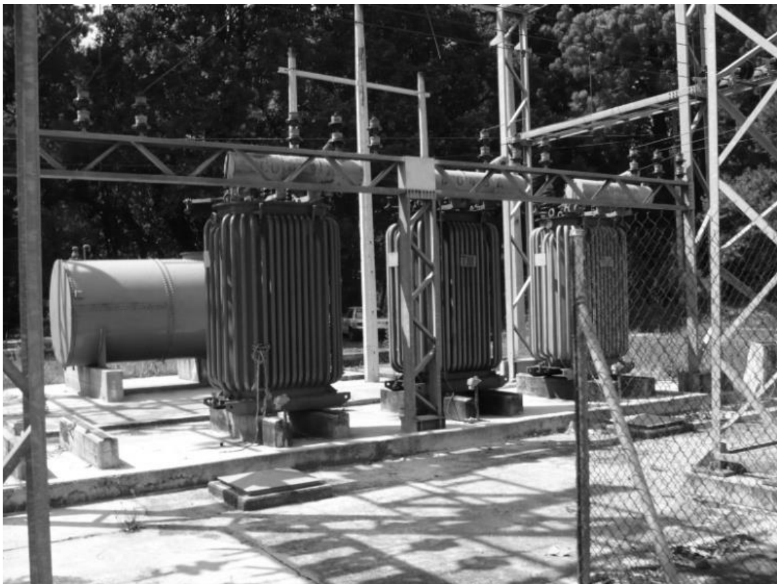
Fig. V.40 Imagen que muestra el área de media-alta tención de la subestación de Zictepec. Fotografíó Eduardo López Cruz (07/12/2007).
