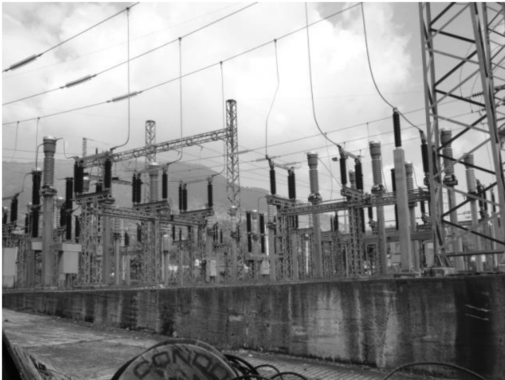
Fig. V.39 Imagen que muestra el área de alta tensión de la subestación de Zictepec. Fotografió Eduardo López Cruz (07/12/2007).
