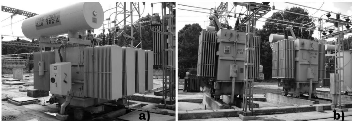
Fig. V.41 Imagen que muestra el área de almacenamiento de energía eléctrica de la subestación de Zictepec; a) banco de almacenamiento y regulación de electricidad, b) bancos o transformadores eléctricos. Fotografió Eduardo López Cruz (07/12/2007).
