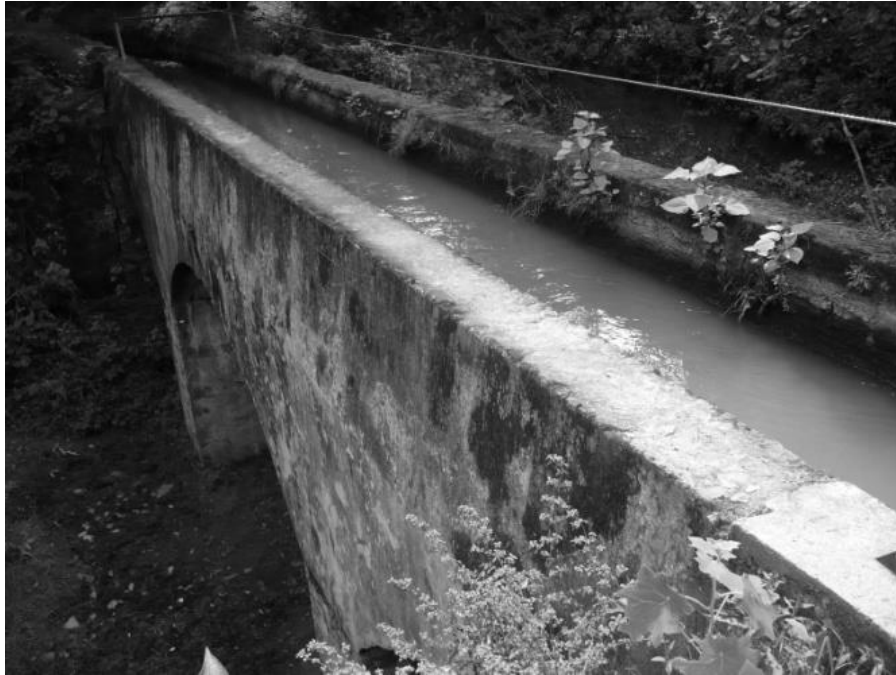
Figs. VII.14 y 15. En estas imágenes se muestran las estructuras del acueducto y sus elementos que lo integran. Fotografió Eduardo López Cruz (07/12/2007).
