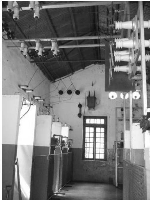
Fig. VII.56 imagen que muestra los bancos e interruptores del generador uno que sirven para la elevación de la energía generada en esta planta. Fotografíó Eduardo López Cruz (07/12/2007).
