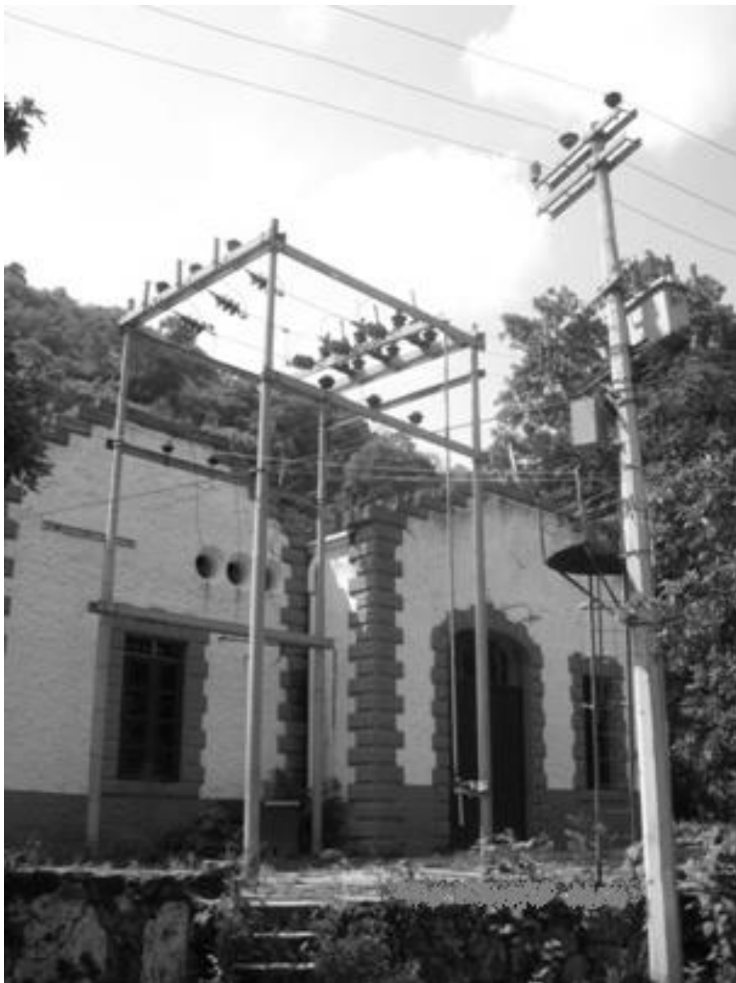
Fig. VII.61, Imagen que muestra la mini subestación de la central de San Simonito, además de sus características y elementos que la componen. Fotografió Eduardo López Cruz (19/06/2007).
